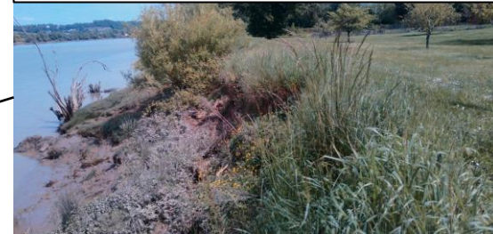
Erosion externe pied de digue
